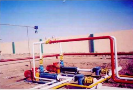
Otogaz İstasyonu Uygulaması Autogas Station Application
